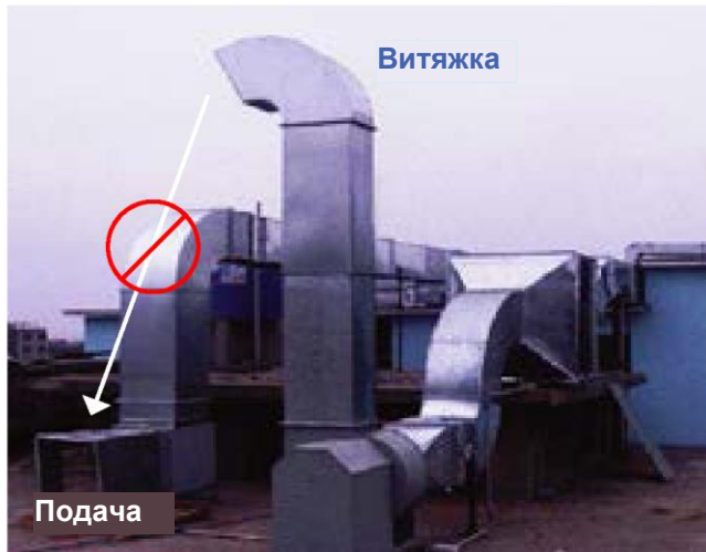
Рис. 3.21. Коротке замикання у системі штучної вентиляції, що спричиняє рециркуляцію забрудненого повітря
